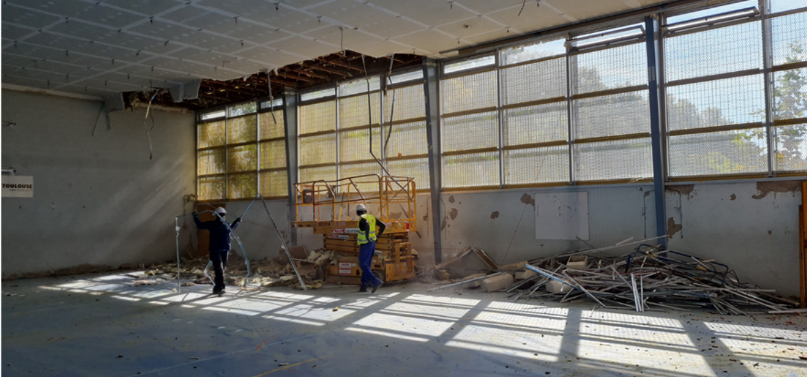
Déconstruction du gymnase Daste à Empalot, chantier sur lequel les matériaux ont été récupérés pour la construction du Moulin à Nef
